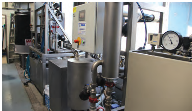
▲連洗横の水のリサイクル装置。熱交換器も設置
